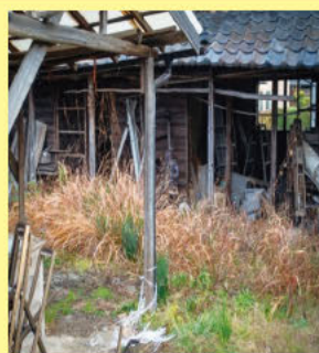
廃墟化した空き家
